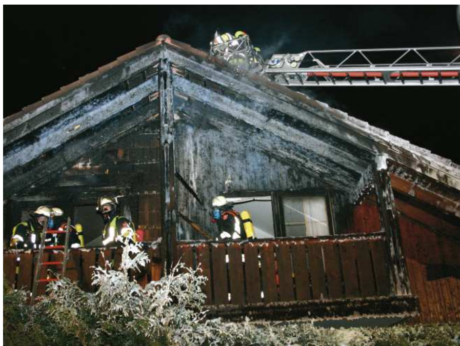
Großer Sachschaden entstand am Doppelhaus. Die Fassade stand lichterloh in Flammen.
