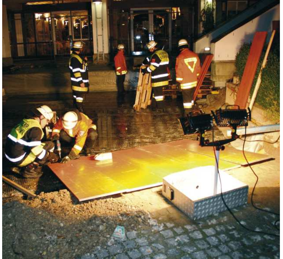
Der provisorische Rettungsweg für mehr als 500 Personen im Notfall.
