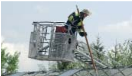
Die Feuerwehr entfernt die Reste eines vom Hagel zerstörten Glasgewächshauses in der Drosselstraße. Foto: Schunk
