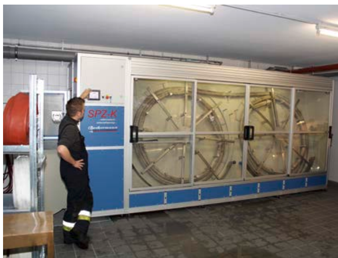
Die automatische Schlauchpflegeanlage im Keller erspart viel Arbeit und Personal.
