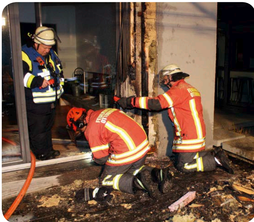
31.10.2017: Rund um die durchgebrannte Terrassentüre wurden die Verkleidung und Wandisolierung entfernt, um eine Ausbreitung des Schmelbrandes zu unterbinden.
