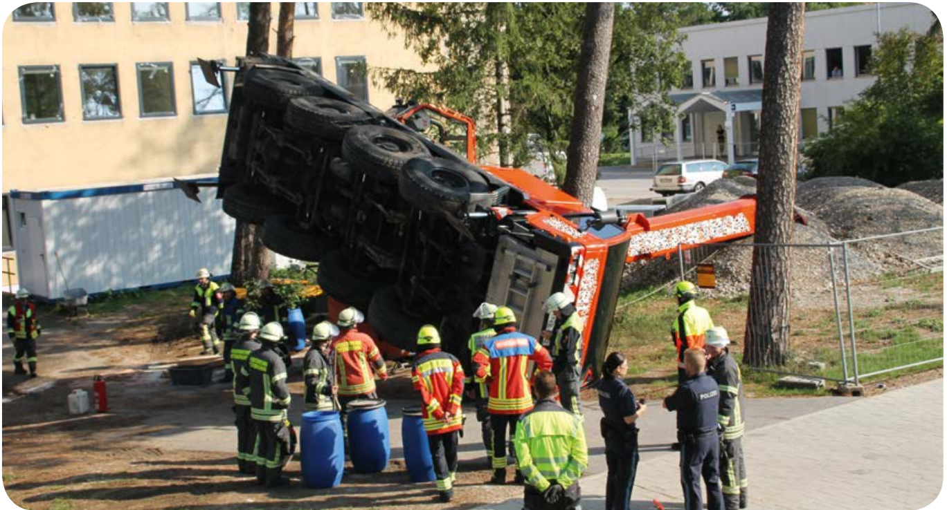
Ein Mobilkran kippte am 05.09.2018 um. Die Feuerwehr fing den auslaufenden Diesel auf und unterstützte bei den Bergemaßnahmen.
