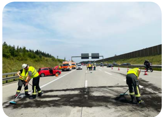
Am 24.7.2021 waren kurz vor dem Autobahnkreuz Süd ausgelauenes Benzin und Motoröl auf der Fahrbahn zu binden.
