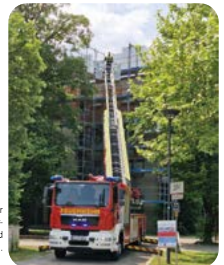
8.6.2025: Auf einer Baustelle drohten Isolierplatten bei starkem Wind davonzufliegen.
