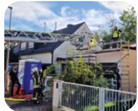
4.9.2025: Bei Dachdeckerarbeiten entstand ein Brand am Übergang vom Garagendach zur Hausfassade.
